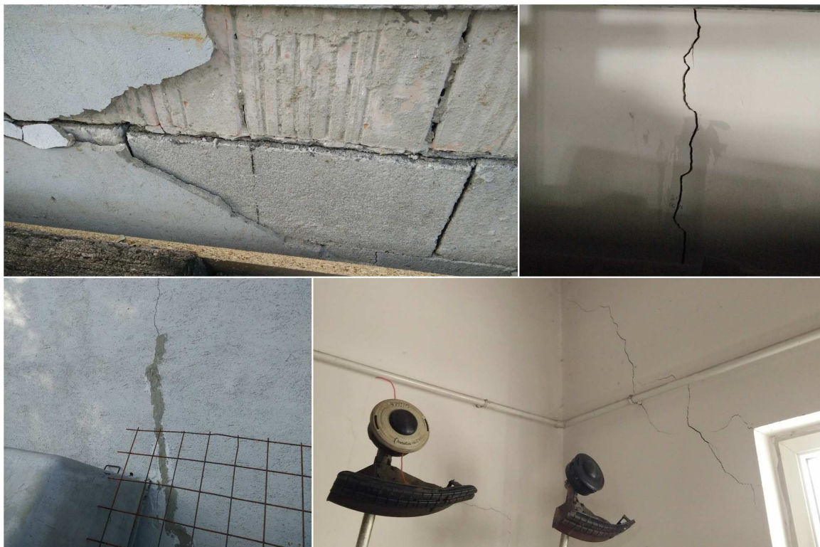
Az épület károsodásának nyomai a falakon
